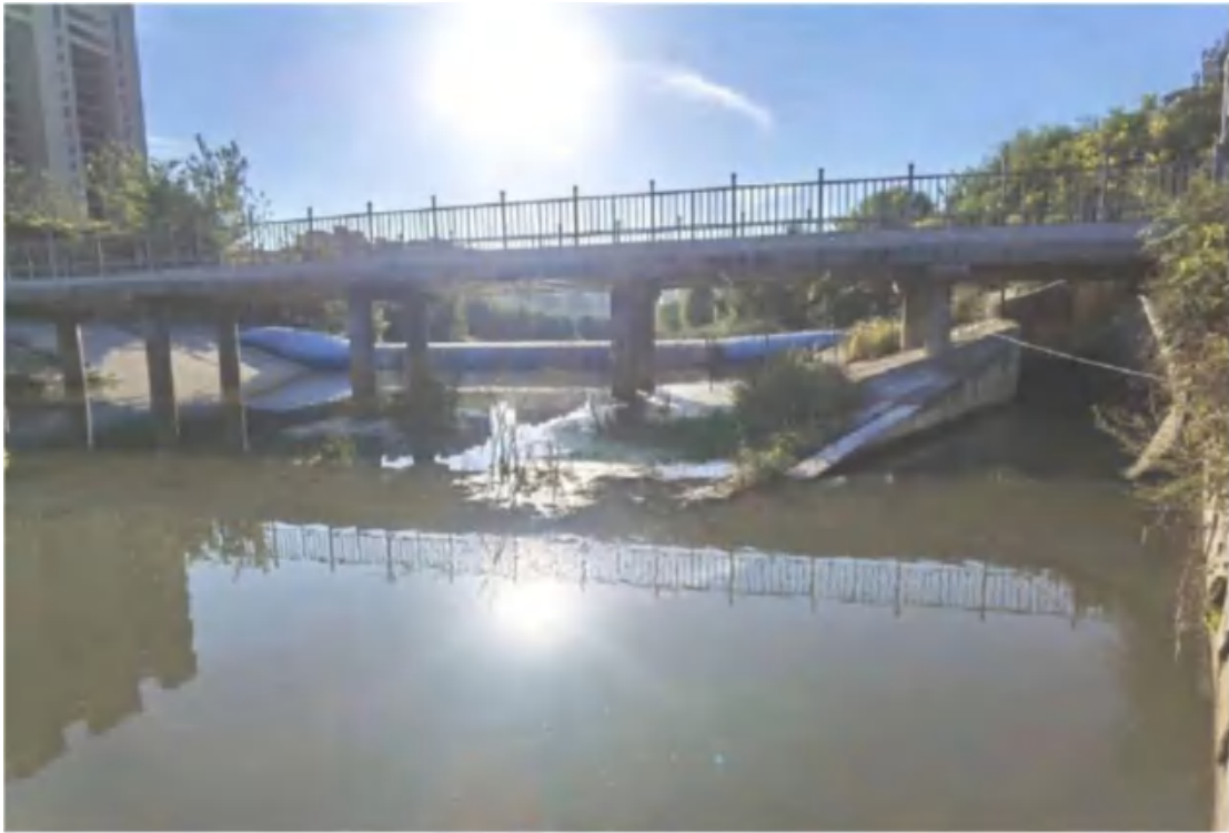
图 3.1-7 G2 高速上游涵洞出口处现状图
